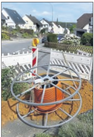
Wie hier in Wickede werden viele Kilometer Glasfaserkabel im Kreis Soest verlegt. • Foto: hütt
